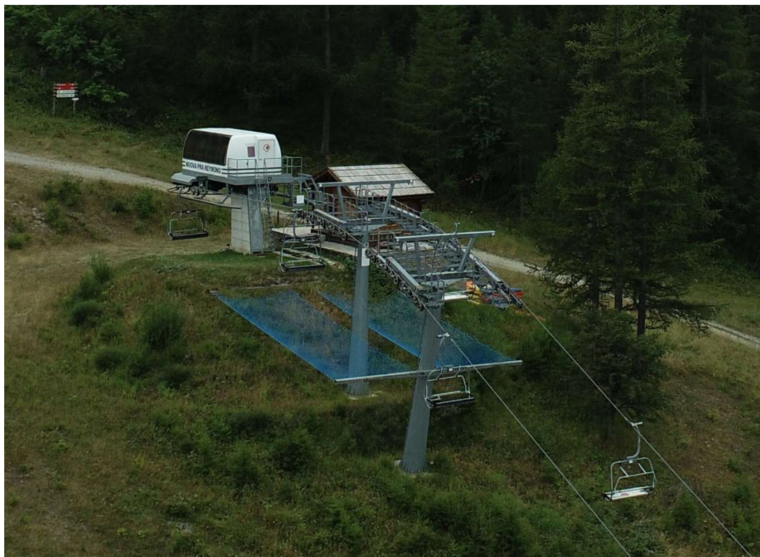
Stazione di monte – motrice ancoraggio
