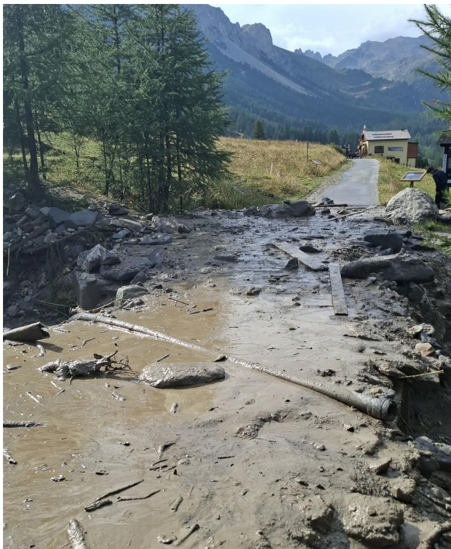
Figura 11: Ponte danneggiato in Valle Stretta.
